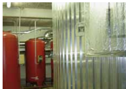
Beispiel Pufferspeicher UG | SIR
