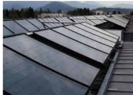
Beispiel Thermische Solaranlage | SIR
