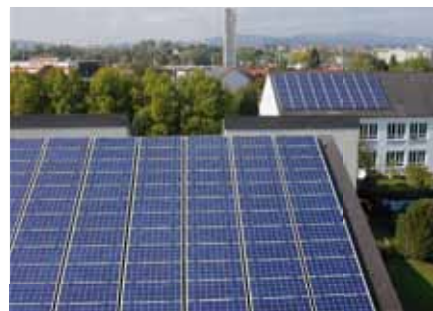
Beispiel Thermische Solaranlage | SIR
